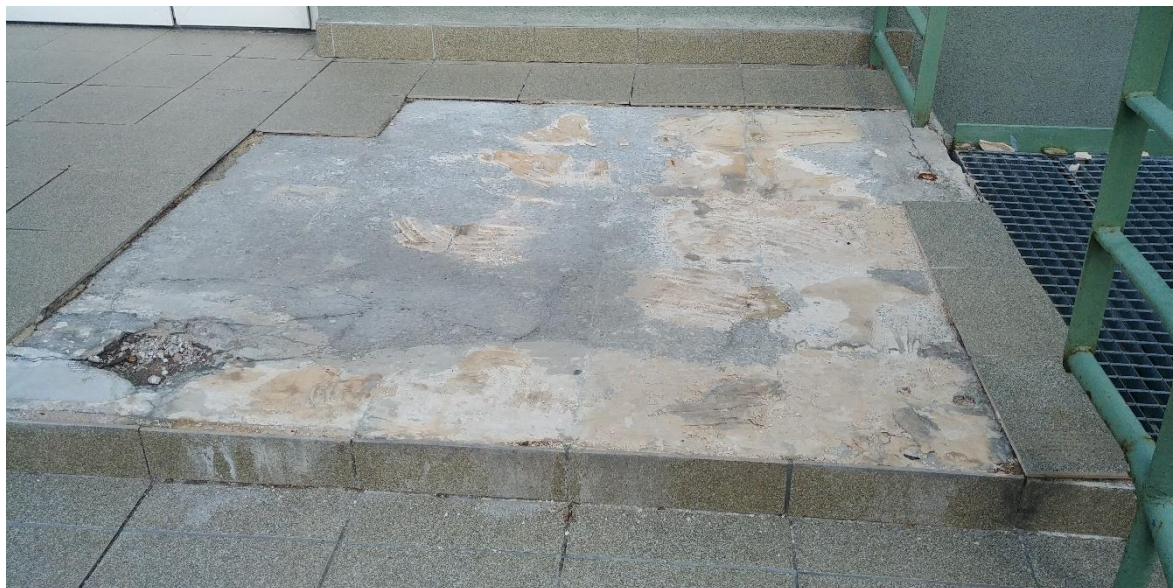
Zdjęcie Nr 2. Odspojone płytki na podeście w wejściu do budynku od strony ulicy (zachodniej).
