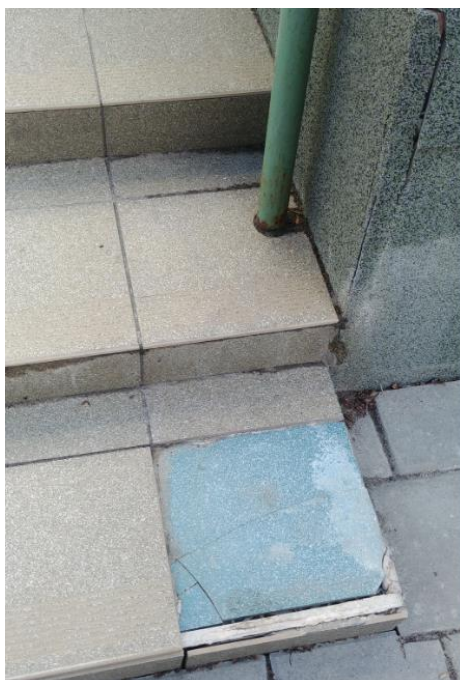
Zdjęcie Nr 1. Odspojone płytki na schodach oraz tynk na ścianie płyty spocznika w wejściu głównym do budynku.
