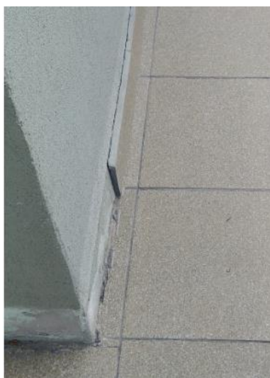
Zdjęcie Nr 3. Odspojone cokoły z płytek ceramicznych na podeście w wejściu do budynku od strony ulicy (zachodniej).
